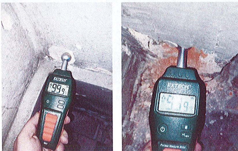
Fot. 20-21 Przykład pomiaru zawilgocenia muru i tynku elewacji zachodniej od wewnątrz w strefie cokołowej
