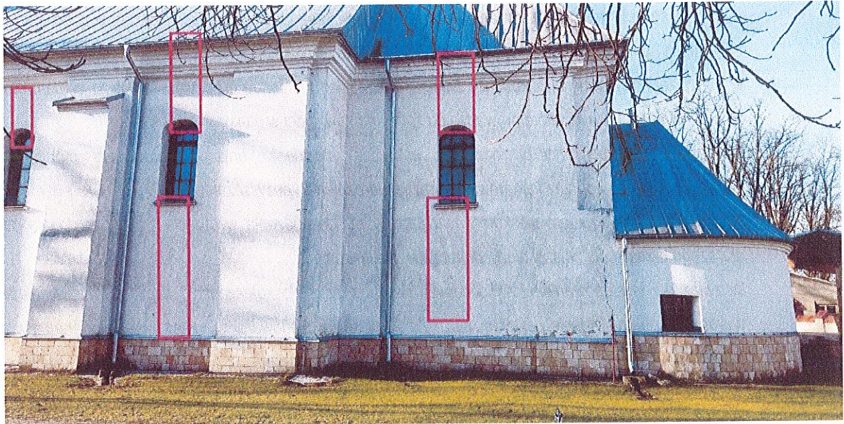
Fot. 9 Przykładowe zarysowania elewacji wschodniej. Złuszczenia powłok powyżej strefy cokolowej. Agresja mikrobiologiczna okładziny kamiennej
