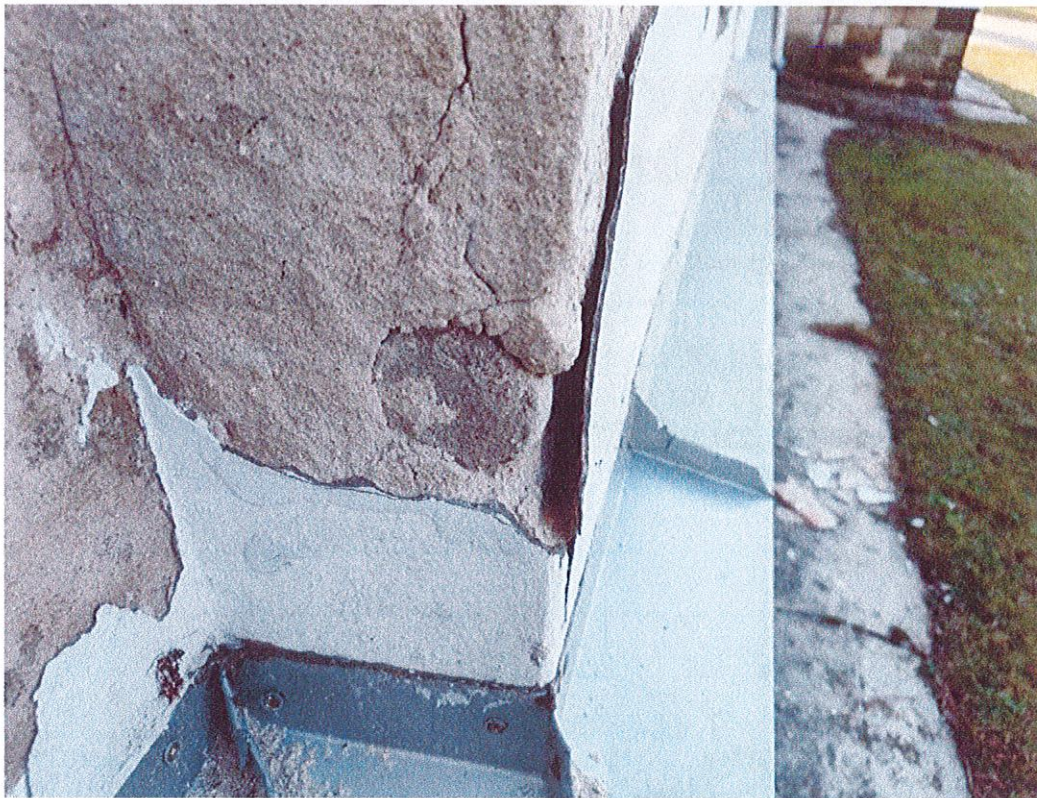
Fot. 16 Uszkodzenia tynków powyżej strefy cokolowej. Rozwarstwienia/uszkodzenia strukturalne tynków. Powłoka malarska wykonana na kleju/zaprawie cementowej.
