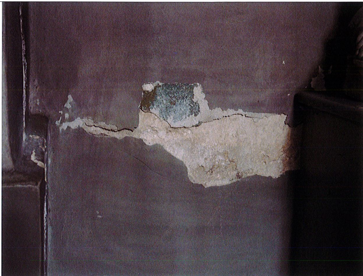
Fot. 18. Ubytki tynku w niszy z rzeźbą świętego
