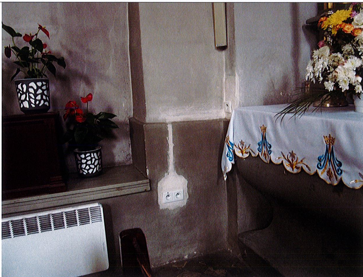
Fot. 19. Wtórna wyprawa w miejscu prowadzenia peszla
