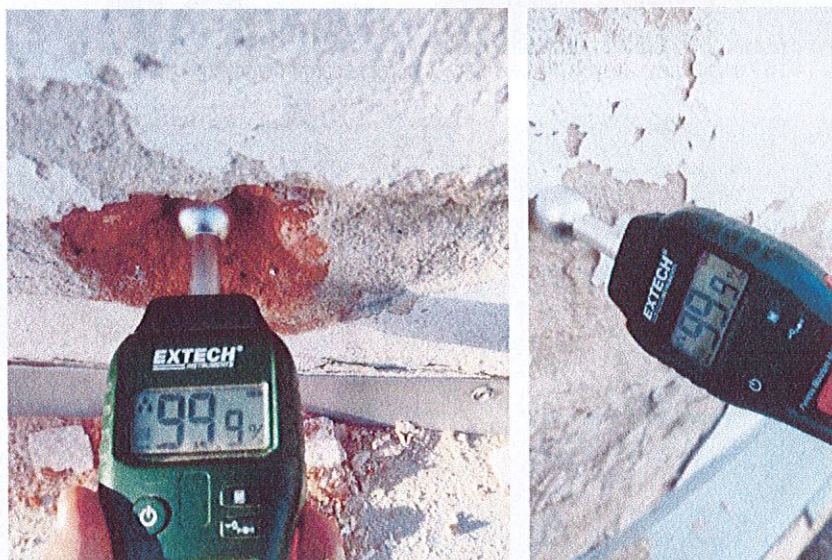
Fot. 18-19 Przykład pomiaru zawilgocenia muru i tynku elewacji wschodniej powyżej strefy cokołowej
