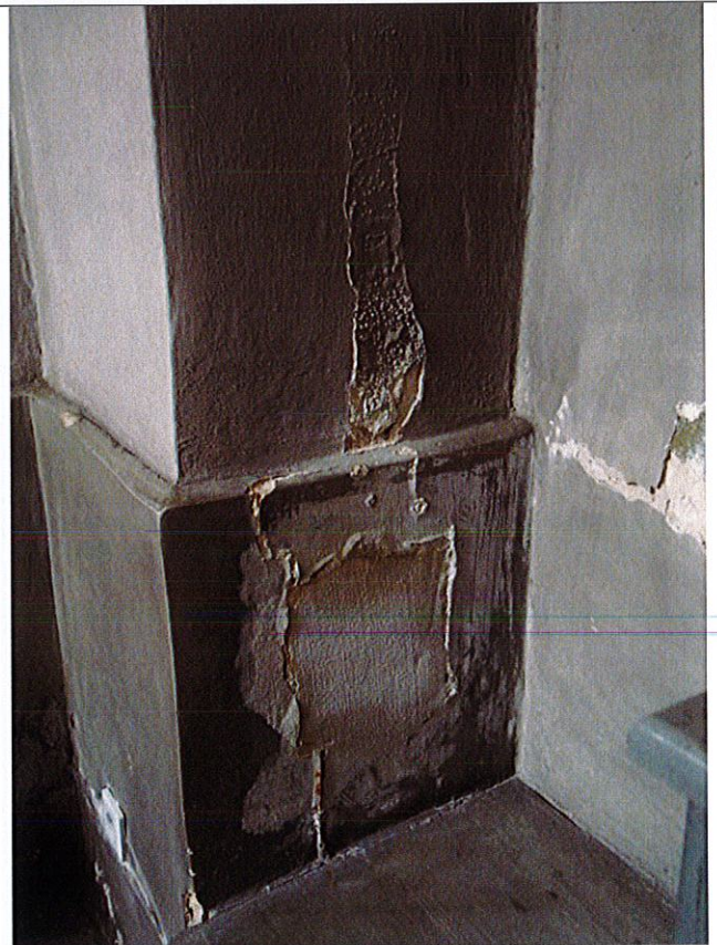
Fot. 13. Zasolenie i uszkodzenie tynku w części przyziemia
