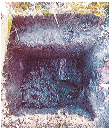
Fot. 29-30 Przykład niedrożnych zatłoczonych studzienek kanalizacji
