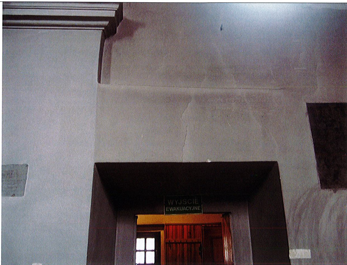
Fot. 14. Ściana w obrębie prezbiterium, widoczne drobne pęknięcia włosowate i zabrudzenia powstałe w wyniku sprzątania kościoła – mycia ścian
