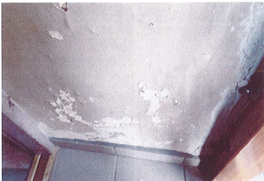
Fot. 17 Przykład złuszczenia powłok olejnych w strefie cokołowej
