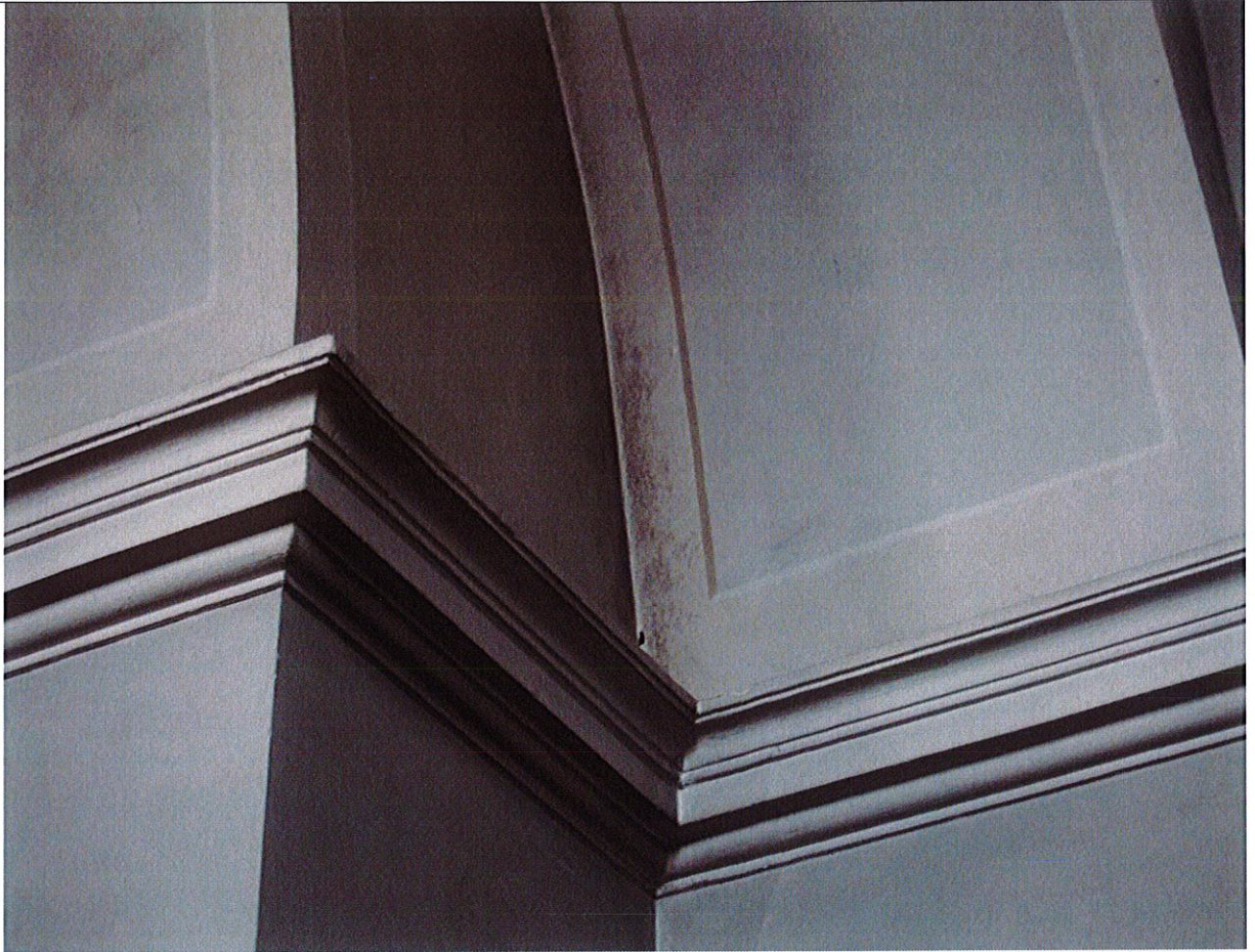
Fot 16. Widoczne ślady zawilgocenia w wyższych partiach kościoła
