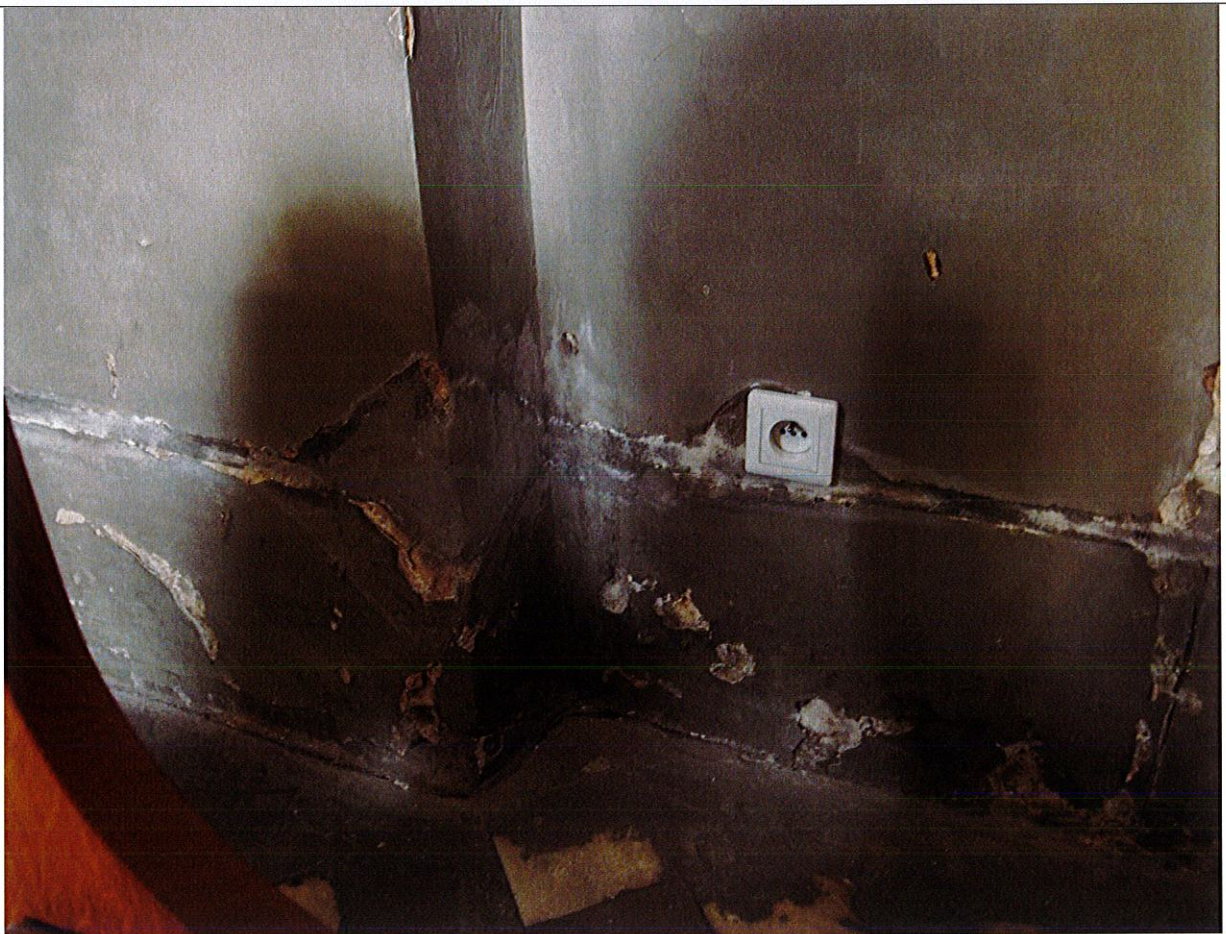
Fot. 17. Zasolenia i ubytki tynku w dolnych partiach ściany północnej
